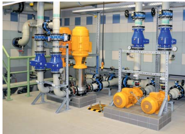
Bild 2: Redundante Pumpensätze in einem modernen Wasserwerk. © Roth
