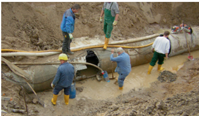
Rohrbruch der Riedleitung bei Gernsheim-Allmendfeld im Juli 2007
