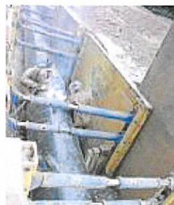
Ein Teil der Rohrleitung.
