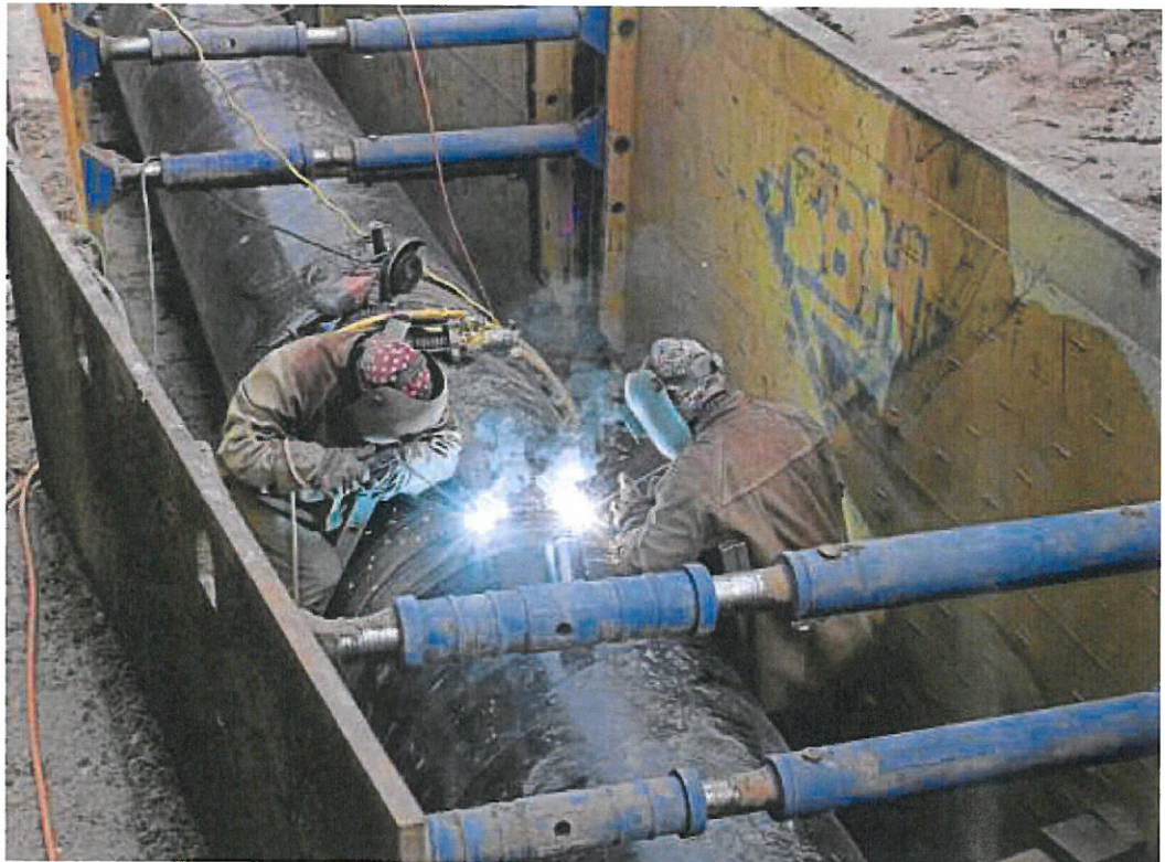
Da fliegen die Funken: Zwei Arbeiter schweißen Stahlrohre zusammen. Fotos: Christian Preußner
